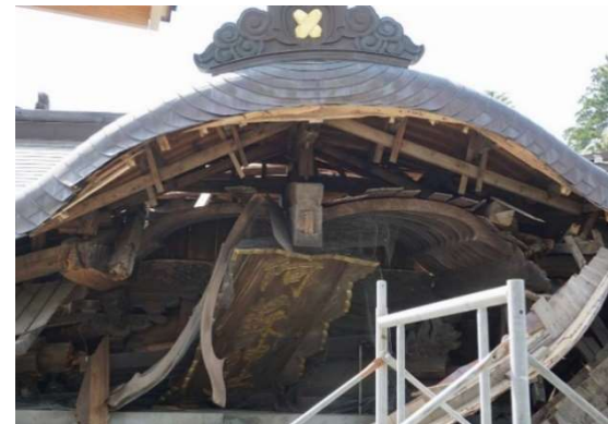
倒壊した楼門 ※震災時
