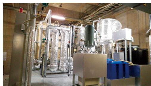
名古屋PARCO 地下水ろ過システム
