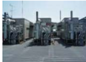
コージェネレーションシステム
