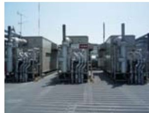
コージェネレーションシステム
